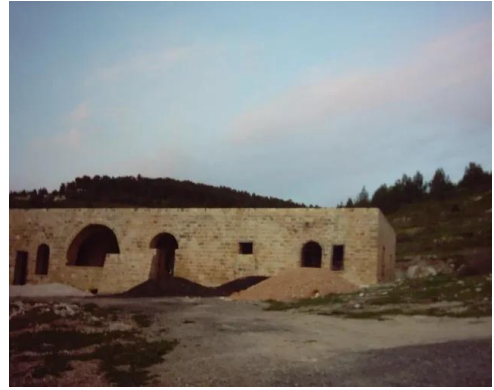
عين الزيتون: بيت كبير من البيوت المتبقية في عين الزيتون, يجري كذلك ترميمه حالياً
