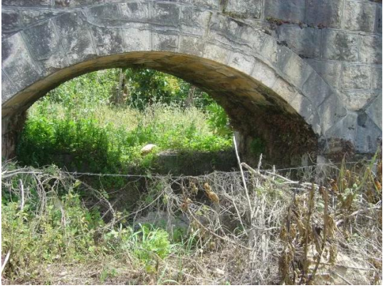
البصة: القناطر منطقة تقع على مفرق الحنية قرب مفرق القليلة في جنوب لبنان يمر من فوق هذه القناطر مجرى مياه لتزويد البستين الزراعية بالماء
